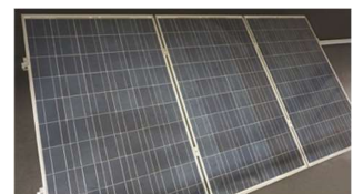
F. Avsluta panelrad med ändklämmor. Bild visar färdigt montage för en rad med 3 st solcellspaneler, stående layout.
